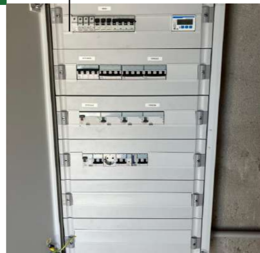
Cuadro eléctrico general
